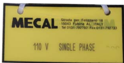
Placa tensión de alimentación
