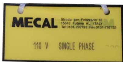
Placa tensión de alimentación
